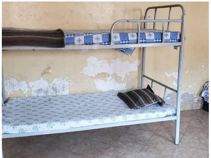
Het stucwerk laat los in de slaapzalen
